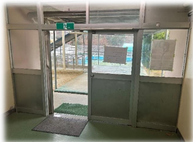
【南館1階 体育館通路扉】
